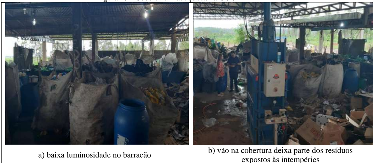
Figura 45 - Cobertura inadequada na COOPERMART.
