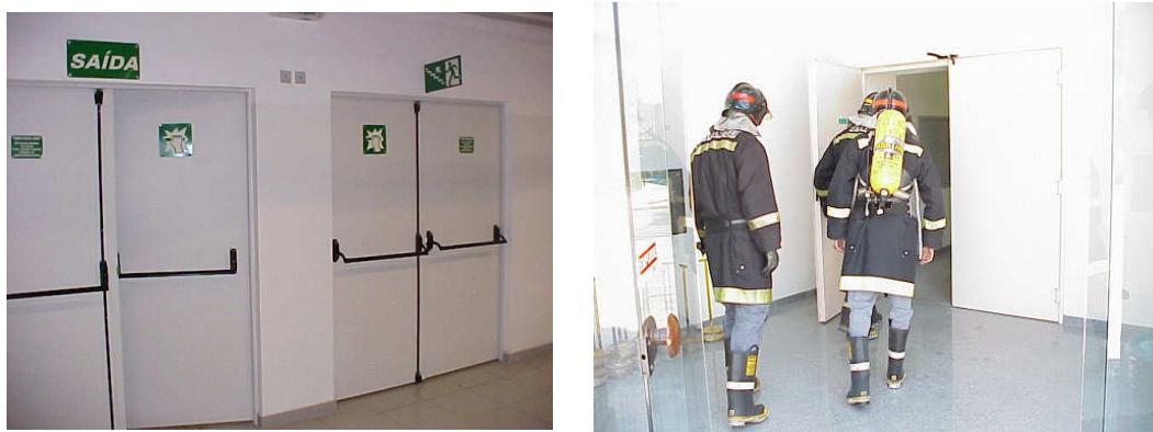
Figura 6 - Saída de emergência. Norma: Fonte: DSCI- CBPMESP
