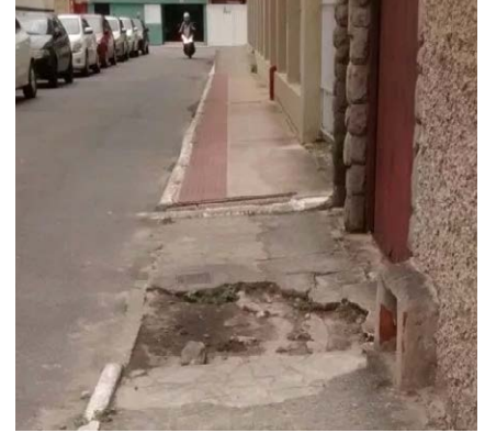
Falta de revestimento adequado e em condições precárias
