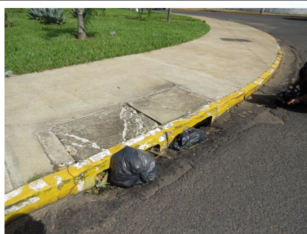
FOTO 13. Detalhe para uma boca de lobo entupida por lixos, diminuindo o escoamento das águas superficiais contribuindo para as inundações.
