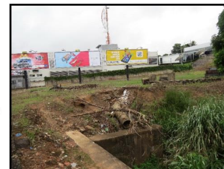
Detalhe do processo erosivo próxima a embocadura do afluente no Córrego do Veado, na margem direita.
