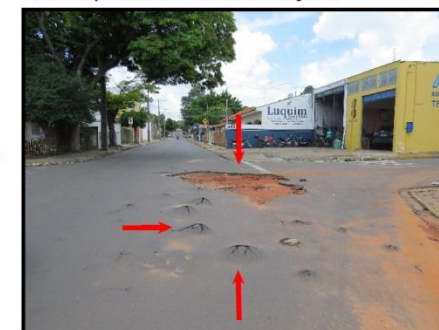
Vista geral da rua Arthur Villa Real, próximo da avenida Brasil. Notar as feições no asfalto (setas vermelhas) que indicam a intensidade da energia da água.
