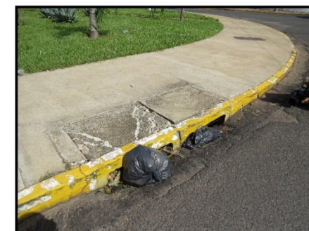
Detalhe para uma boca de lobo entupida por lixos, contribuindo para as inundações.
