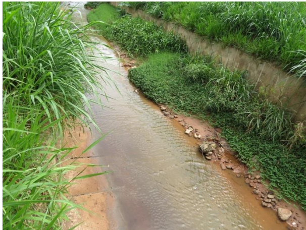
FOTO 19. Vista do córrego próximo da rua Ana Jacinta. Notar que o canal apresenta um pouco de vegetação e entulho em sua calha.
