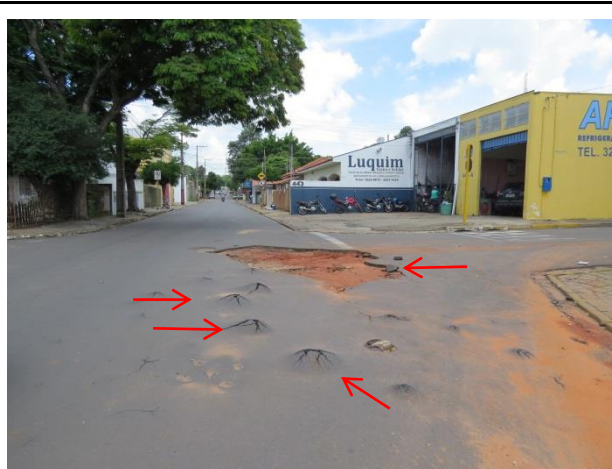
FOTO 15. Vista geral da rua Arthur Villa Real, próximo da avenida Brasil. Notar as feições no asfalto (setas vermelhas) que indicam a intensidade da energia da água.
