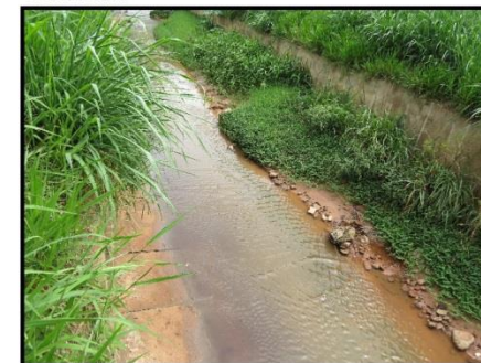
Notar que o canal apresenta um pouco de vegetação e entulho em sua calha.
