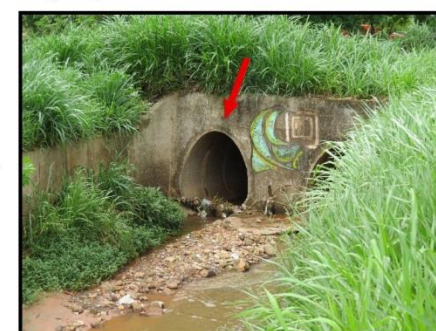
Detalhe para as estruturas de canalização (ovular) que atravessam a rua Ana Jacinta. Em períodos de chuvas intensas esta rua chega a apresentar pontos de inundação.
