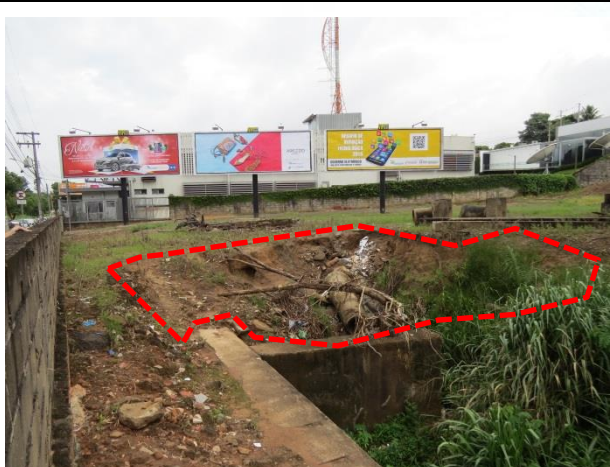
FOTO 3. Detalhe do processo erosivo (polígono) próximo à embocadura do afluente no Córrego do Veado, na margem direita.
