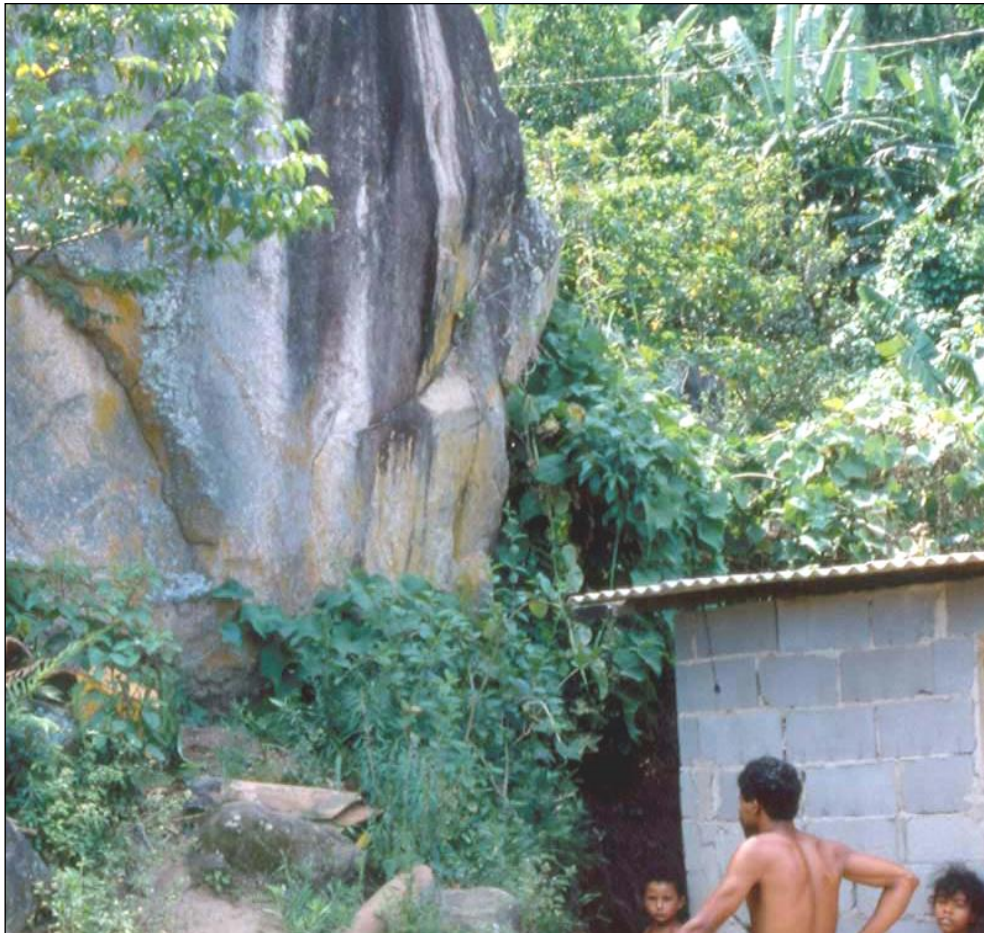
Figura 11 – Situação de risco de tombamento de bloco rochoso (Ministério das Cidades, Instituto de Pesquisas Tecnológicas do Estado de São Paulo – IPT, 2007).
