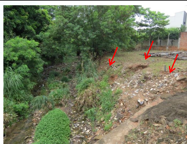
FOTO 4. Detalhe da margem esquerda do afluente, com presença de processos erosivos (setas) e entulho depositado sobre o talude marginal.
