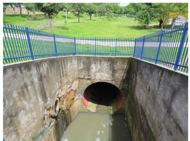
FOTO 10. Detalhe do canal do córrego do Veado em um dos poucos trechos que não se apresenta confinado. O córrego é canalizado em uma estrutura de, aproximadamente, 5 m de diâmetro, que, segundo o histórico de inundação, aparenta ser insuficiente para a vazão do córrego.
