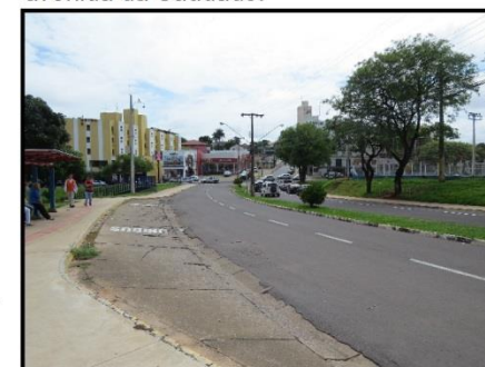
Vista do afluente do Córrego do Viado. Notar a quantidade de lixo e entulho no talude marginal e no canal deste.
