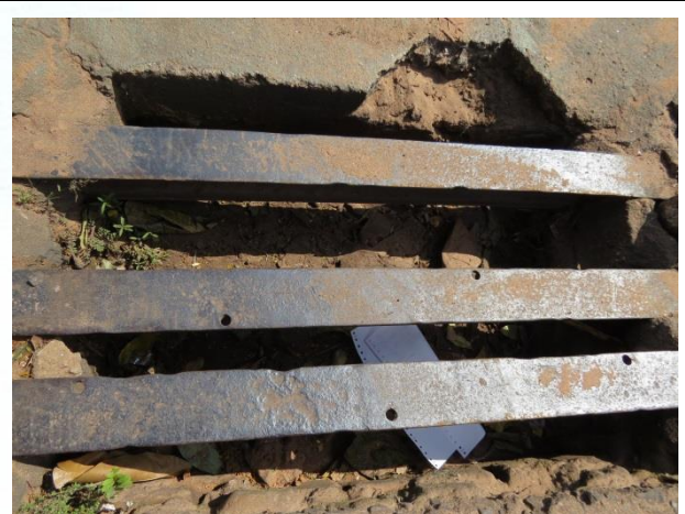
FOTO 14. Detalhe para uma estrutura de escoamento da drenagem superficial completamente entupida por sedimentos, que acaba por contribuir para o processo de inundação.
