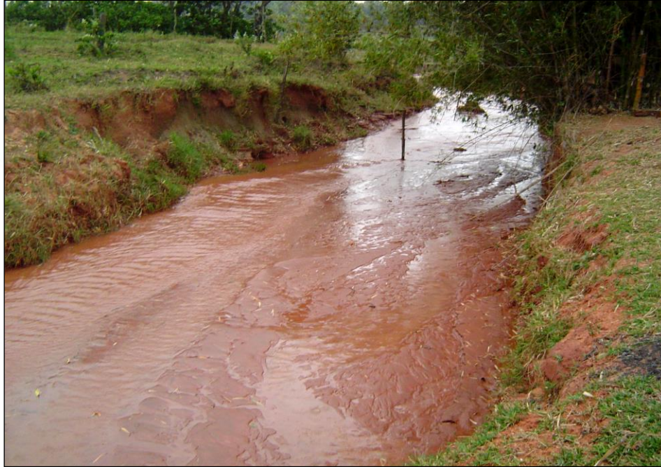
Figura 22 – Taludes marginais sujeitos a erosão (Ministério das Cidades, Instituto de Pesquisas Tecnológicas do Estado de São Paulo – IPT, 2007).
