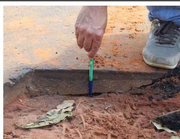
FOTO 16. Detalhe para a estrutura que se formou devido ao rompimento do asfalto pela ação da água.
