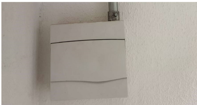
Figura 5: Quadro de distribuição presente no interior do box.
