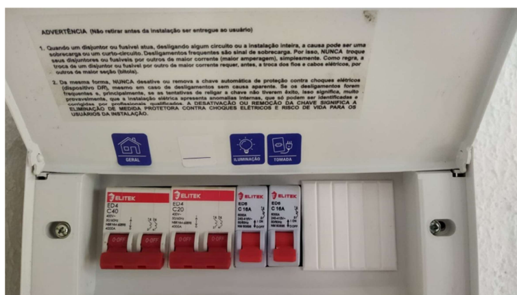
Figura 6: Distribuição dos disjuntores no interior do quadro.
